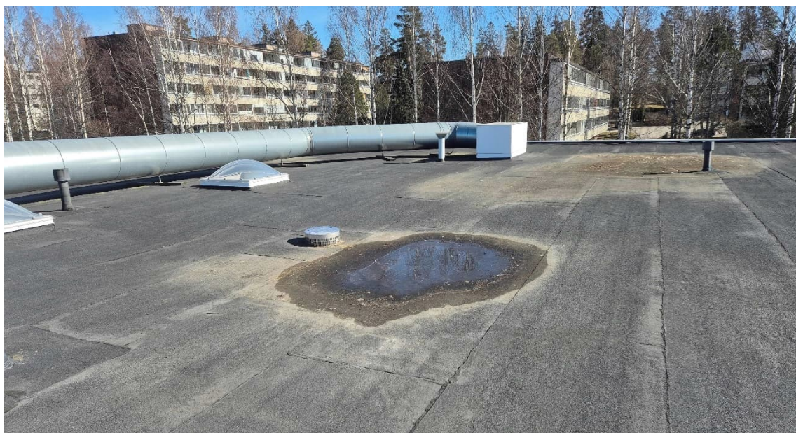
Kuva 23. Vettä lammikoituu katolle kallistuspuutteiden vuoksi.
