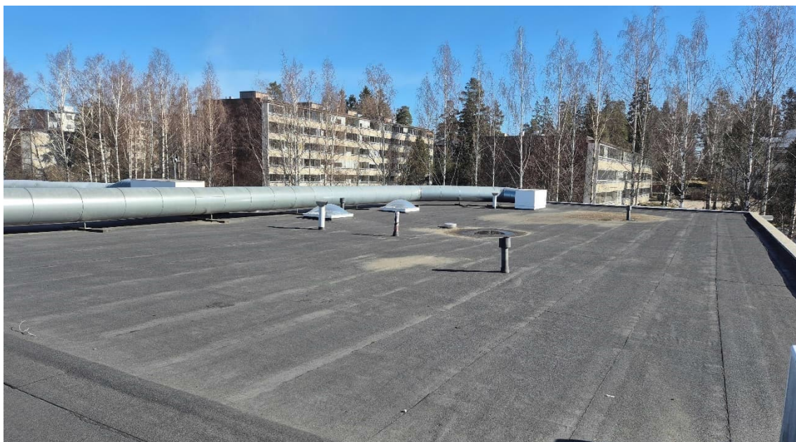
Kuva 22. Vuonna 1979 valmistuneen rakennusosan vesikatto. Kermikate on uusittu noin vuonna 2004. Vettä lammikoituu katolle kuvassa näkyvien vaaleampien kohtien kohdalle kallistuspuutteiden vuoksi.
