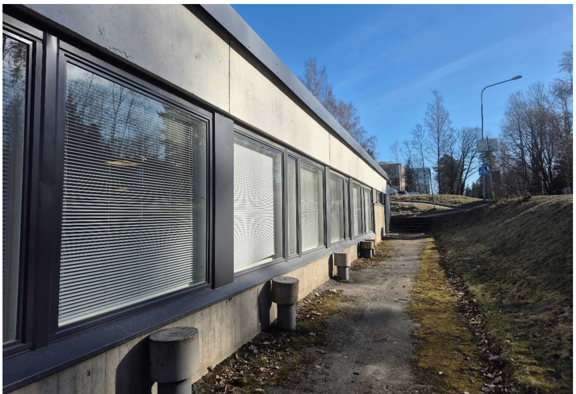
Kuva 9. Alkuperäisen rakennusosan betonijulkisivua keittiösiiven osuudella. Betonijulkisivussa oli monin paikoin pinnassa olevat raudoitteet ruostuneet ja lohkaisseet betonipintaa. Ikkunat ja niiden väliin jäävät peltiverhotut julkisivut on uusittu vuonna 2016.
